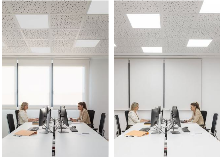
Iberspa, 2022. Casambi lighting control. Daytime slot / Night-time slot. Contrôle de l'éclairage Casambi. Plage horaire de jour / Plage horaire de nuit.
